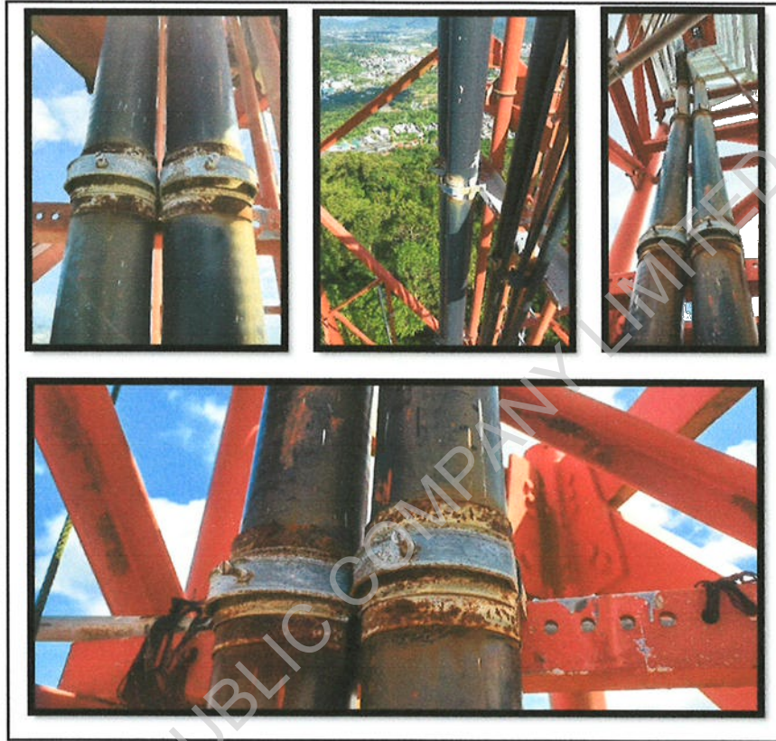
รูปที่ 36 ตรวจสอบแคล้มจับสายสัญญาณเสาอากาศ พบเป็นสนิมเกือบทุกตัว
