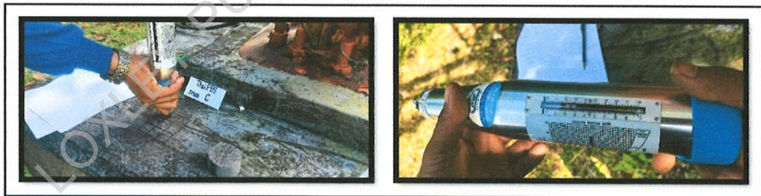
รูปที่20 ภาพตรวจความแข็งแรง (Strength) ของคอนกรีตฐานราก C=256 KG/CM 2
