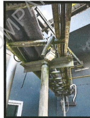
รูปที่11 Inlet Feeder
