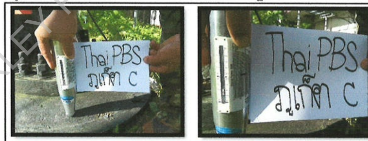
รูปที่23 ภาพตรวจความแข็ง (Strength) ของคอนกรีตฐานราก C=460 KG/CM 2
