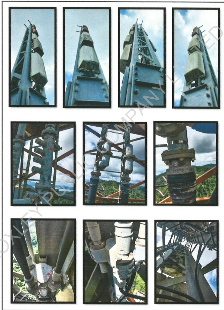
รูปที่23 ตรวจสอบแผงอุปกรณ์ส่งสัญญาณอยู่ในสภาพสมบูรณ์
