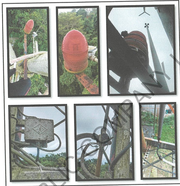
รูปที่ 25 ระบบไฟสัญญาณ OB Light
