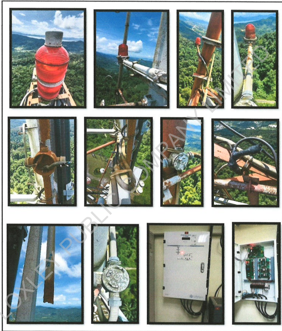
รูปที่34 ตรวจสอบโคมไฟ สายไฟ บล็อกต่อแยกสาย เก้าและแตกชำรุด ขาดติดตั้งโคมไฟเป็นสนิมทั้งหมด
