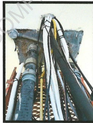
รูปที่8 Inlet Feeder
