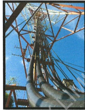
รูปที่9 Vertical Feeder Rack
