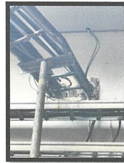
รูปที่ 9 Inlet Feeder
