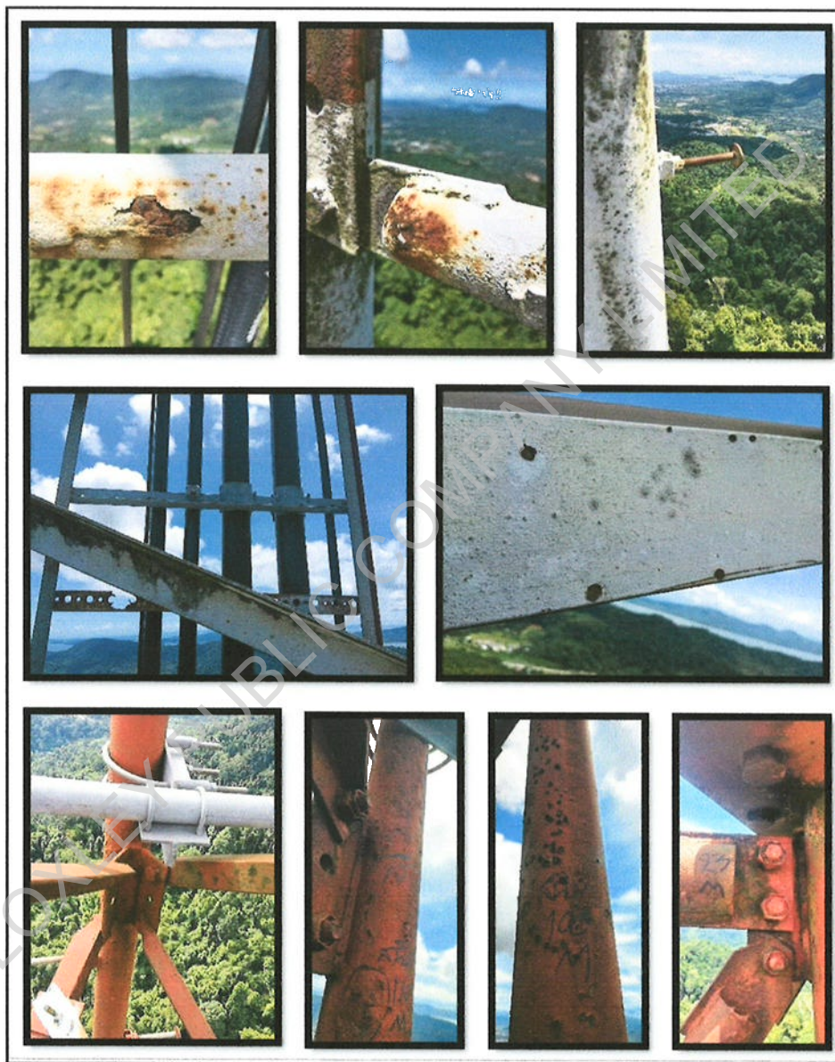
รูปที่ 36 ตรวจสอบสภาพสีเสาส่งฯ พบสีโครงสร้างมีคราบตะไคร่น้ำจำนวนมาก สีลอกร่อนเป็นแผ่น สีซีดจาง และ เกิดเริ่ม สนิมบนผิวโครงสร้างเสาส่งฯ มากกว่า 80% ของโครงสร้างทั้งหมด
