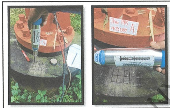
รูปที่ 19 ภาพตรวจความแข็ง (Strength) ของคอนกรีตฐานราก A=396 KG/CM 2
