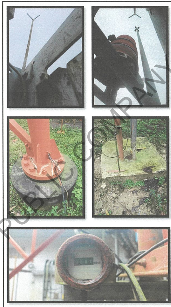
รูปที่ 18 Ground และระบบล่อฟ้า
