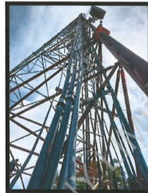
รูปที่6 Vertical Feeder Rack
