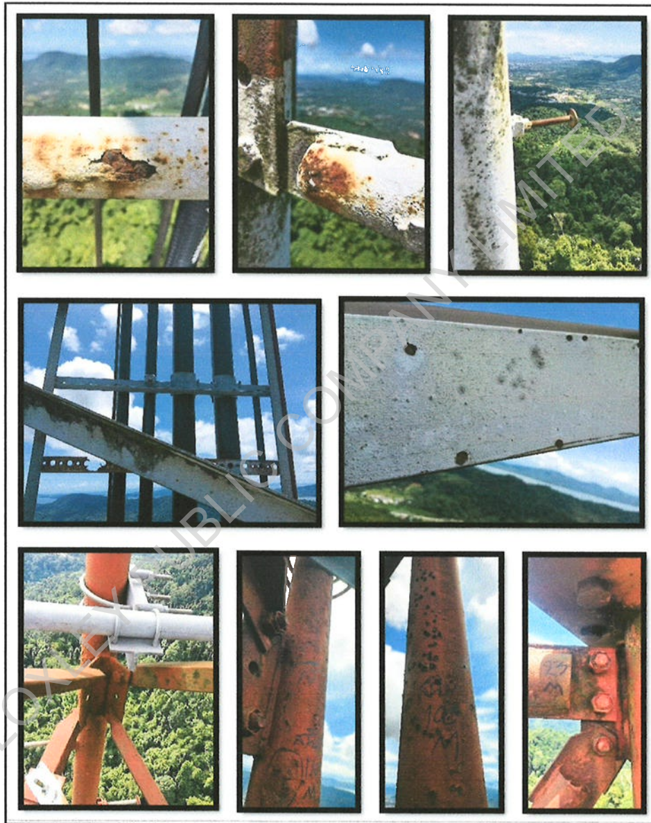
รูปที่ 36 ตรวจสอบสภาพสีเสาส่งฯ พบสีโครงสร้างมีคราบตะไคร่น้ำจำนวนมาก สีลอกร่อนเป็นแผ่น สีซีดจาง และ เกิดเริ่ม สนิมบนผิวโครงสร้างเสาส่งฯ มากกว่า 80% ของโครงสร้างทั้งหมด
