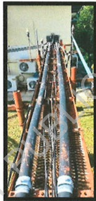
รูปที่7 Horizontal Feeder Rack
