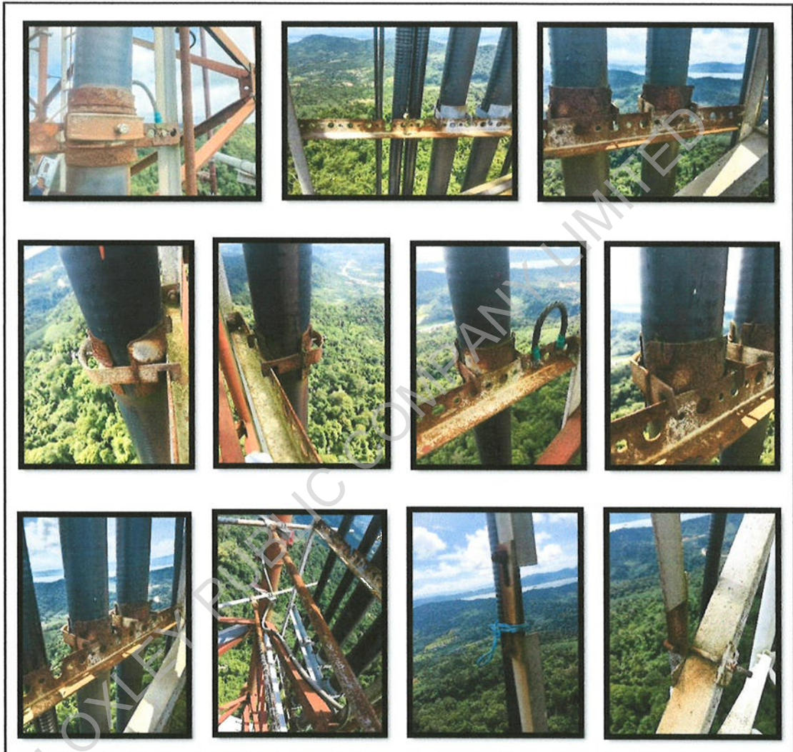
รูปที่33 ตรวจสอบ Vertical Ladder สำหรับจับแคล้มสายสัญญาณ พบชำรุดเสียหาย เนื่องจากสนิมจำนวนมาก
