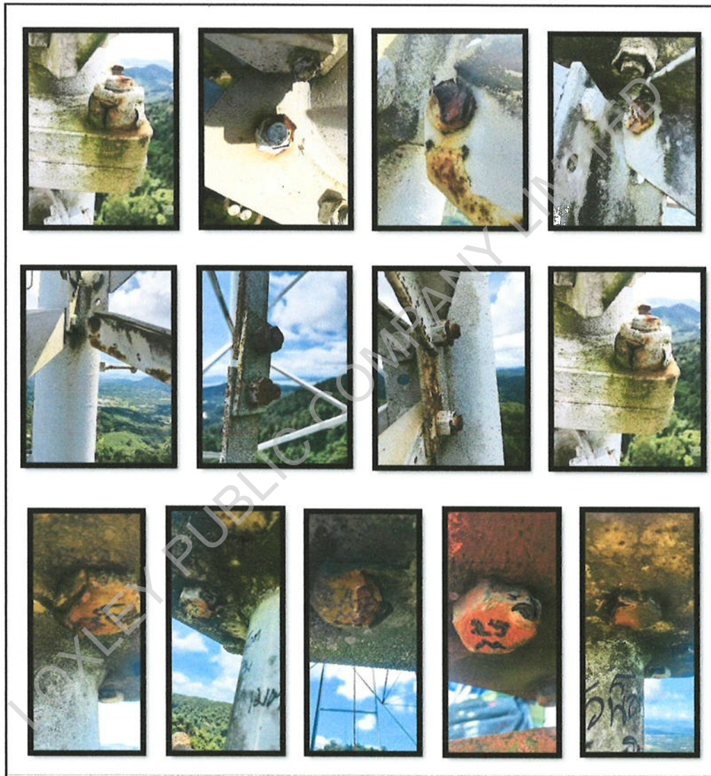
รูปที่ 25 ตรวจสอบ Bolt-Nut โครงสร้างเสาส่งๆ เกิดสนิมเสียหายจำนวนมาก
