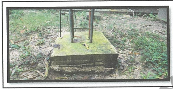
รูปที่ 31 ตรวจสอบพบ ดินทรุดบริเวณต่อม่อันไคเสาสูงๆ
