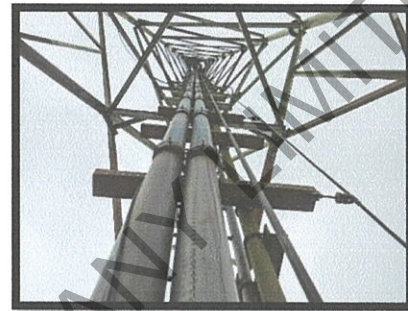
รูปที่ 7 Vertical Feeder Rack
