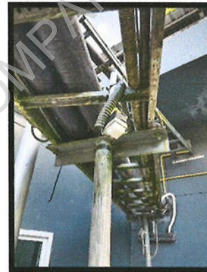
รูปที่11 Inlet Feeder
