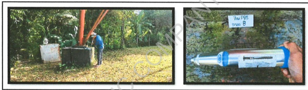
รูปที่19 ภาพตรวจความแข็ง (Strength) ของคอนกรีตฐานราก B=318 KG/CM 2
